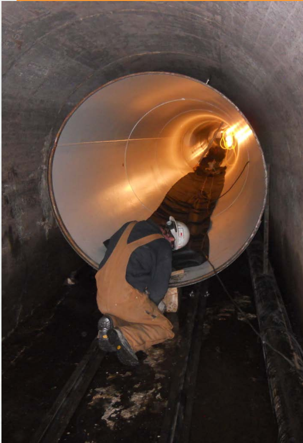
Steel Conduit Liner
