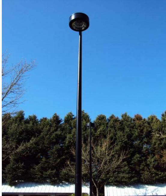
Figure 3.4. Original 400 W metal halide luminaire
