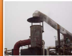
Boiler Heat Recover (Tulare)
