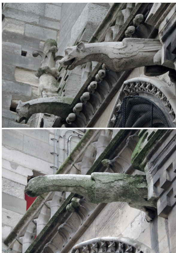
Rysunek 6.4-1. Gotyckie zakończenia rynny dachowej (tzw. gargulce) z Katedry Notre-Dame w Paryżu: a) odrestaurowane, b) uszkodzone w wyniku wymywania gipsu (zdjęcie: M. Reizer).
