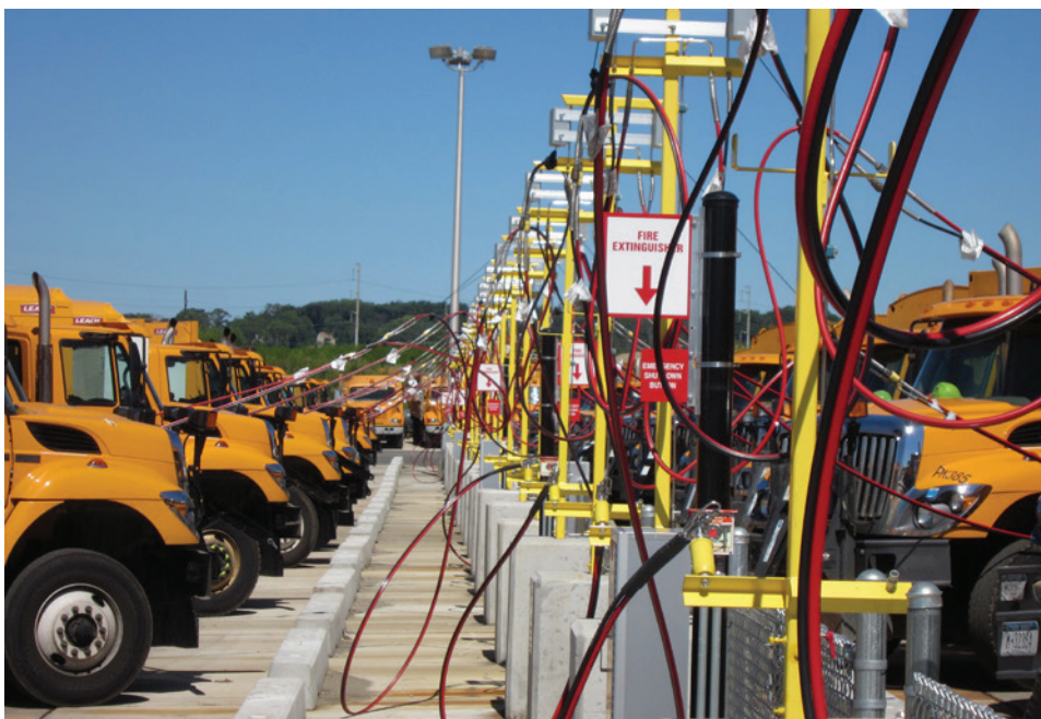
En la estación de reabastecimiento de CNG de Oyster Bay, Nueva York, los vehículos utilizan la conexión de tiempo de llenado. Foto de Greater Long Island Clean Cities, NREL 23853
