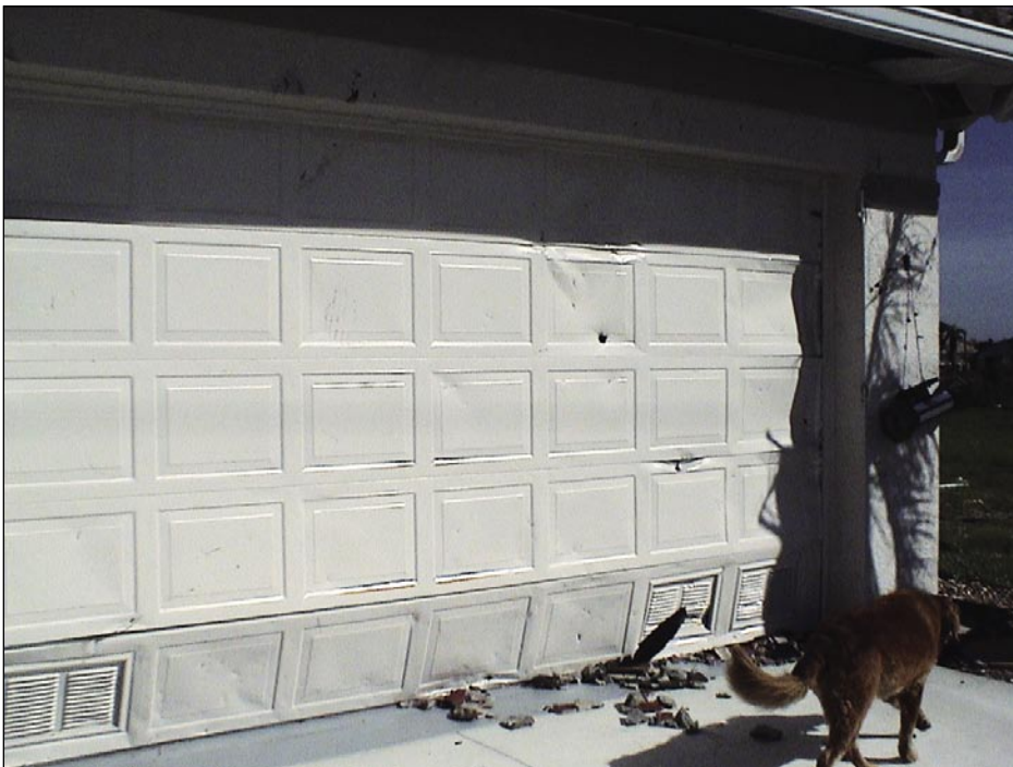
Figure 3-36. Tile damage to a metal-panel garage door (Punta Gorda)
