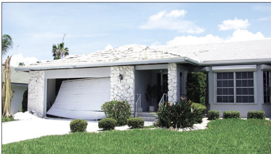
Figure 3-16. Foam set tile roof covering failure (Punta Gorda)
