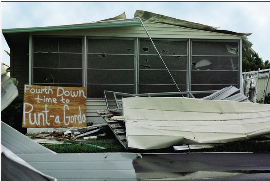
Figure 4-23. Damaged screened porch (Punta Gorda)
