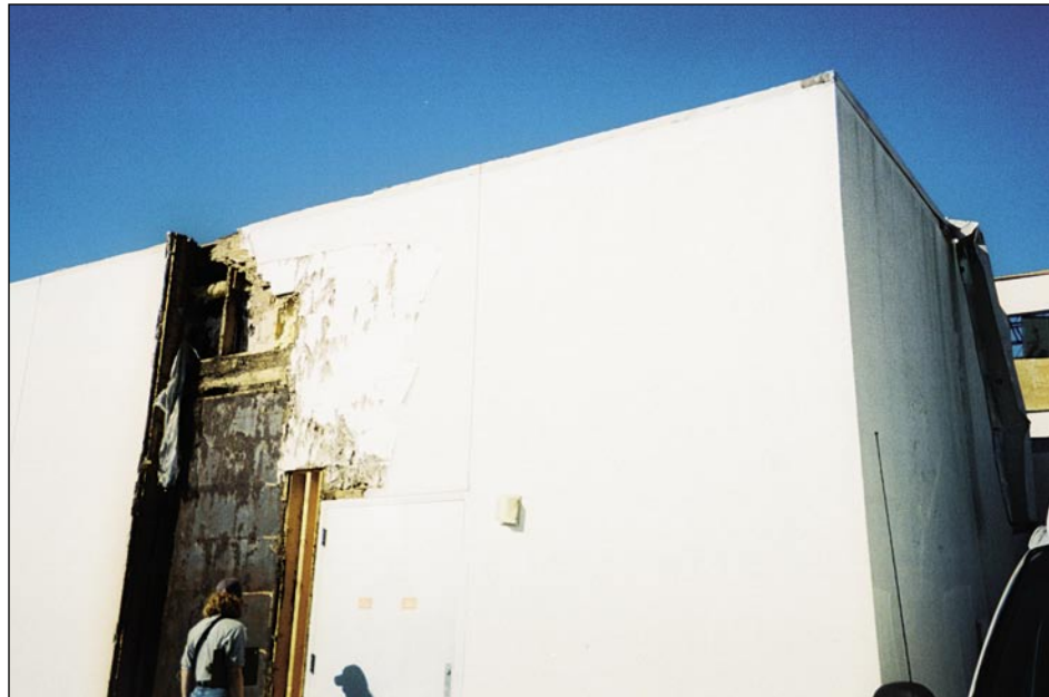
Figure 3-26. Example of damage to EIFS wall panels (Punta Gorda)
