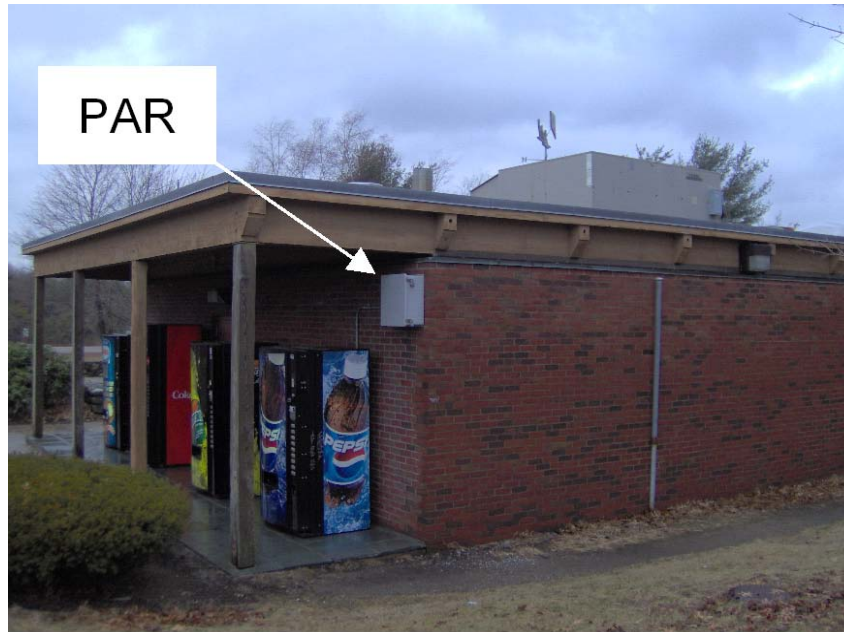
Figure 5. PAR Installation at MM9
