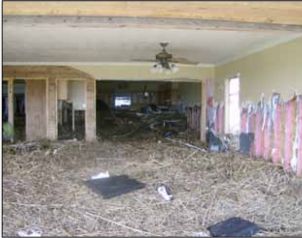
Arriba: Residencia inundada por la marejada ciclónica asociada al Huracán Ike en Bridge City, TX. TX—TX DPS
