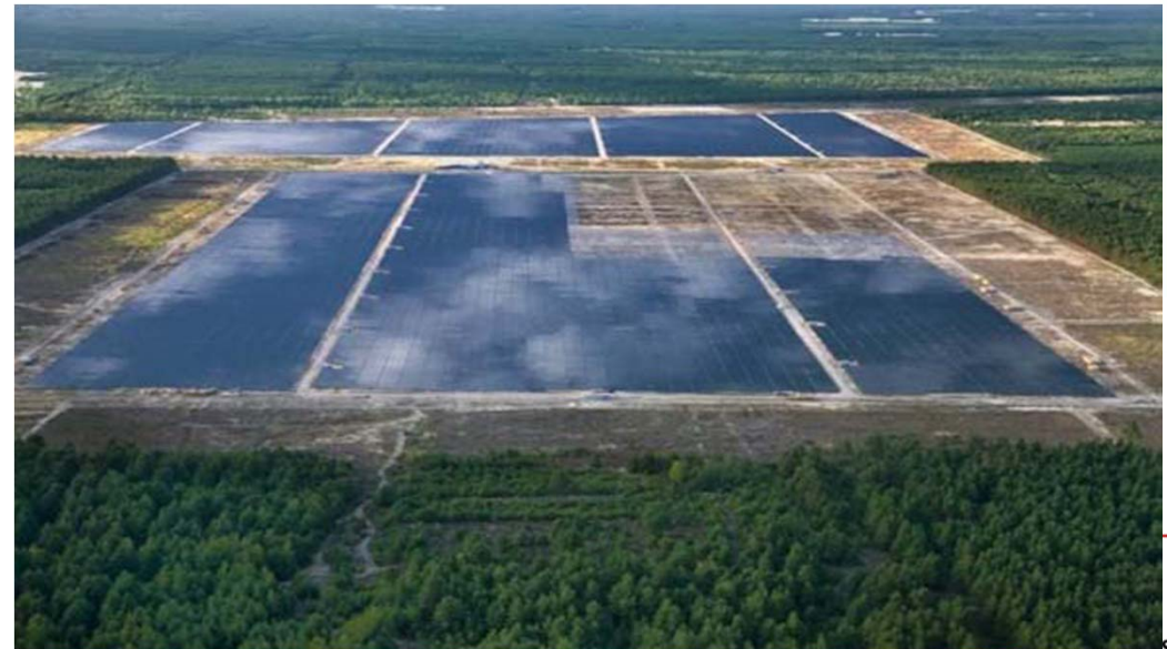
Waldpolenz Solar Park (40 MW)
