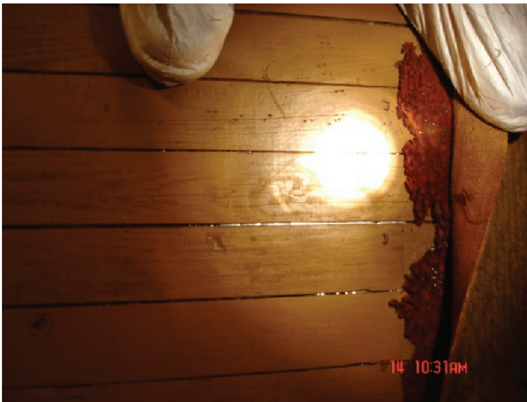
Figura 1a: Contaminación con mercurio en paneles del piso de una casa.
