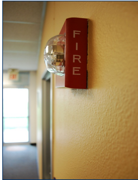
Alarma de incendios con luces estroboscópicas
