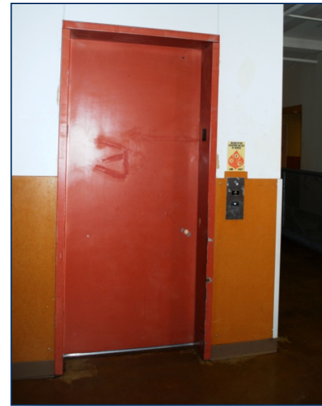
Ascensor al segundo piso en el refugio de emergencia
