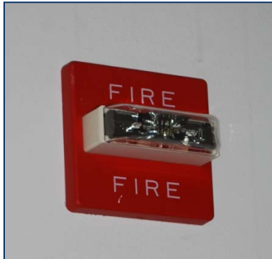
Alarma de incendios con luces estroboscópicas
