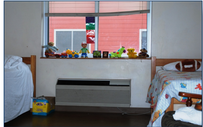
Unidad de aire acondicionado con control individual en la habitación del refugio de emergencia
