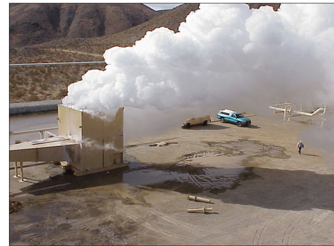
Instalación de energía geotérmica en los Laboratorios Nacionales Sandia. Crédito de la foto: Los Laboratorios Nacionales Sandia/Sandia National Laboratory
