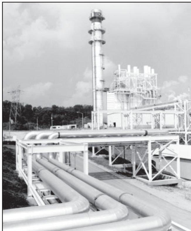
Steam lines from HRSG
