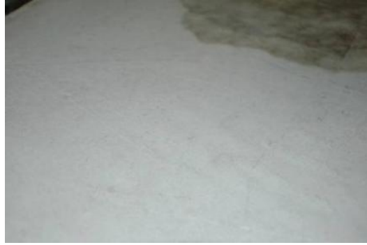
(b) – Smooth Concrete (NIJ)
