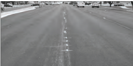
No se deben dejar las marcas temporales por más de 2 semanas si no lo obliga una decisión basada en ingeniería.
