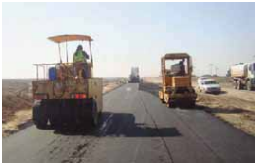
عمال يقومون برصف طريق النقل العمارة اليمونة، (صورة فيلق المهندسين بالجيش الأمريكي)
