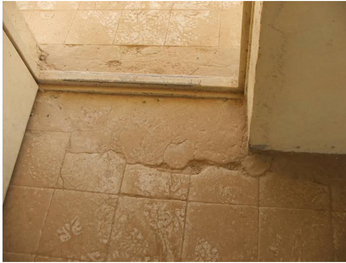
Site Photo 7. Uneven floors
