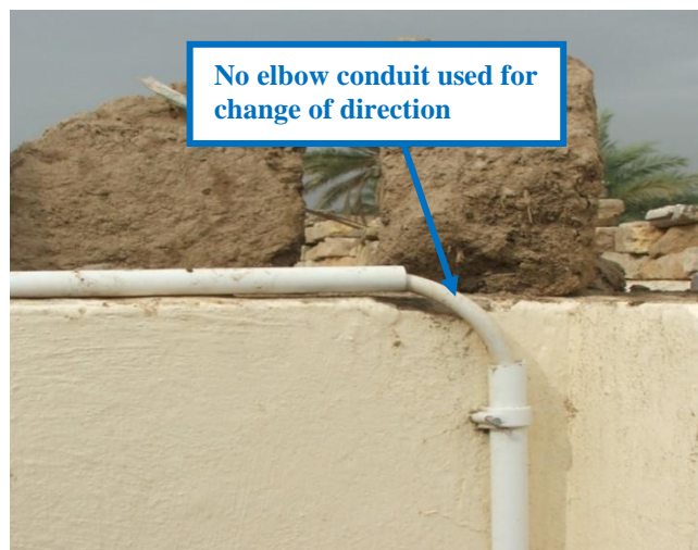
Site Photo 12. Exterior conduit
