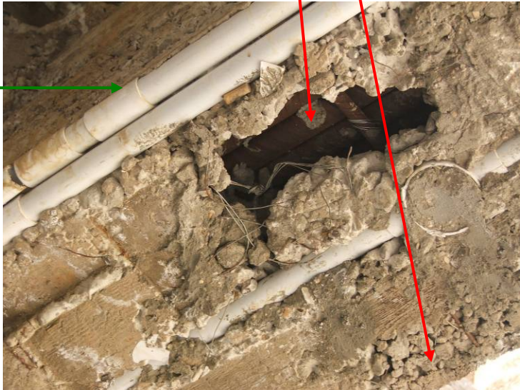
Site Photo 26. Concrete voids and electrical conduit exposure
