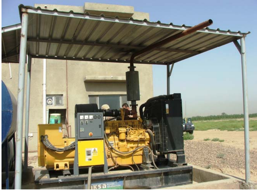
Site Photo 11. Landfill site electrical generator
