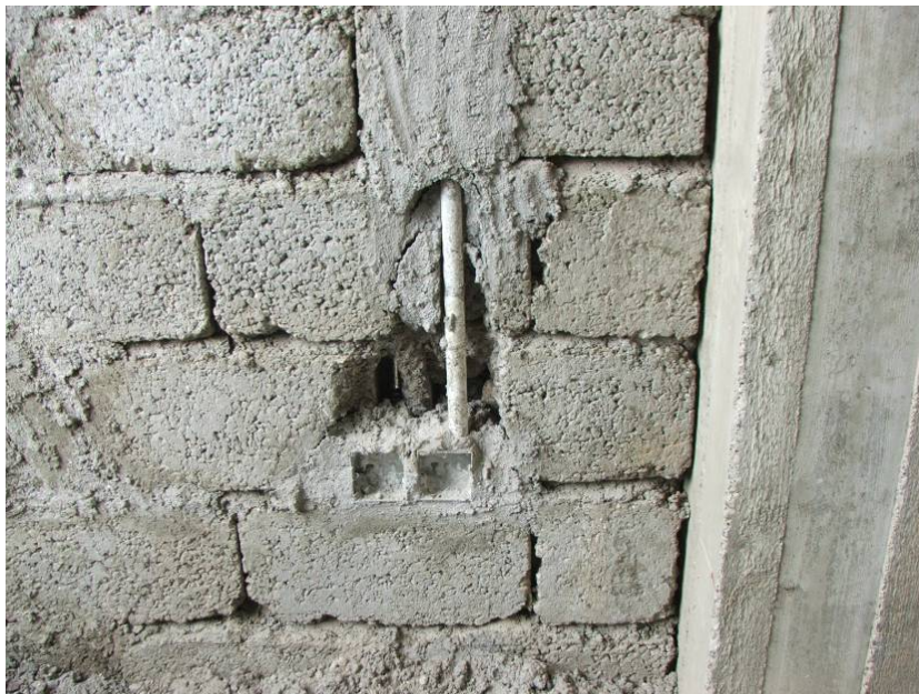
Site Photo 55. PVC conduit and electrical box
