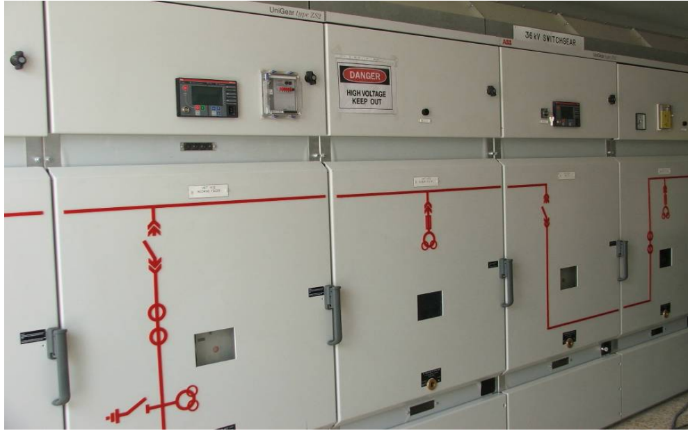
Site Photo 3: 33 kV Switchgear
