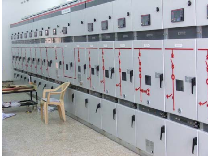
Site Photo 4: 11kV switchgear
