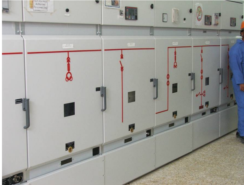
Site Photo 3: 33kV Switchgear
