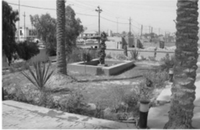
الصورة - ٣ نافورة مياه غير شغالة، نباتات تسوير غير موجودة، وعدد غير صحيح من أنوار الحدائق
