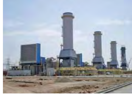
محطة كهرباء غاز إربيل، التي بناها وشغلها القطاع الخاص، كان متوسط إنتاجها، خلال ربع السنة الحالي، ٣٦٨ ميغواط، أي ٧٥ بالمئة من قدرتها الأساسية المتاحة.
