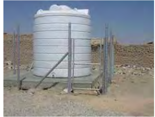
خزانات مياه مركب في الزهور، محافظة القادسية (صورة لمكتب شؤون المحافظات)
