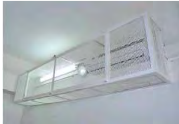
قفص معدني يحمي الأسلاك الكهربائية لأنظمة التدفئة والتهوية وتكييف الهواء، والإنارة
