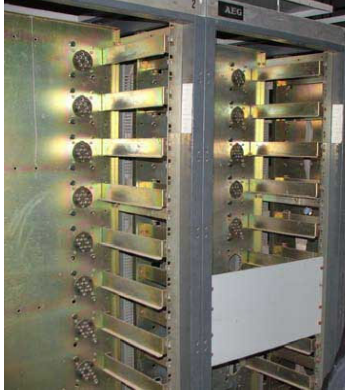
معدات إلكترونية ناقصة في محطة التحويل الكهربائية للمدرج
