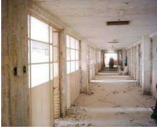
منظر للحواجز الداخلية قبل إعادة تجديدها (الصورة مقدمة من سلاح الهندسة في الجيش الأميركي)
