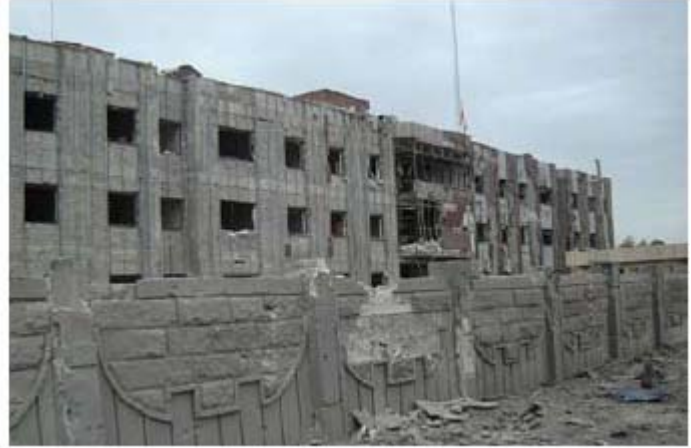
الأضرار في الجهة الشمالية لمبنى الخدمات والجدار المحيط
