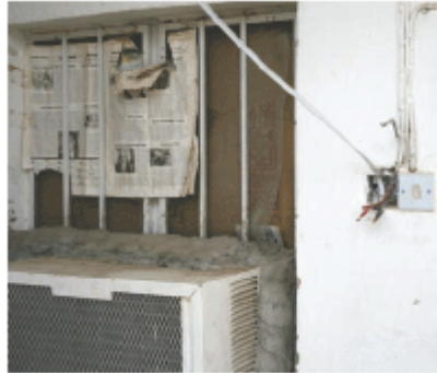
مفتاح كهربائي موصول عشوائياً
