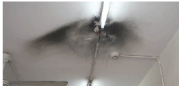
أضرار حريق كهربائي حول شاسيات الإنارة الفلورية
