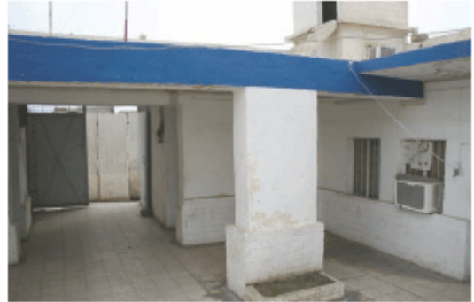
أسلاك كهربائية معلقة بصورة غير صحيحة
