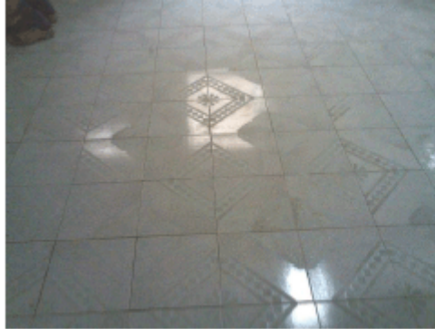
إصلاح أرضية الحمام من قبل المقاول بعد تفتيش المفتش العام (الصورة مزودة من قبل شركة وستين انك)
