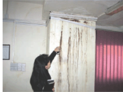
أضرار المياه في غرفة العمليات في الطابق الأول
