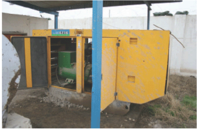
مولد متروك بدون خط وقود مع مستويات زيت منخفضة ومفاتيح تحويل التشغيل وأنظمة التحكم مكسورة
