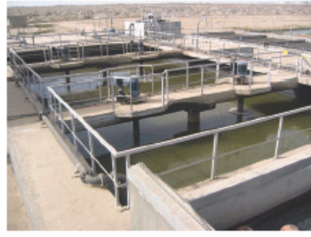
محطة معالجة مياه الصرف الصحي في قاعدة تليل العسكرية
