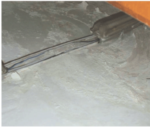
أضرار المياه داخل غرفة العمليات في الطابق الأول عند أول زيارة لمفتشي المفتش العام في كانون الثاني/يناير 2007
