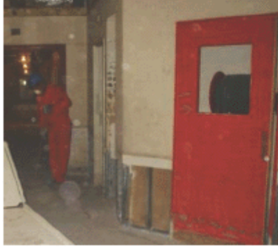
ممر، باب فولاذي أُلْفِته المياه، ولوحة حص أنلقتها المياه، كان من الضروري نزعها قبل التجديد. (صورة من سلاح الهندسة في الجيش الأميركي، 18 حزيران/يونيو 2005)
