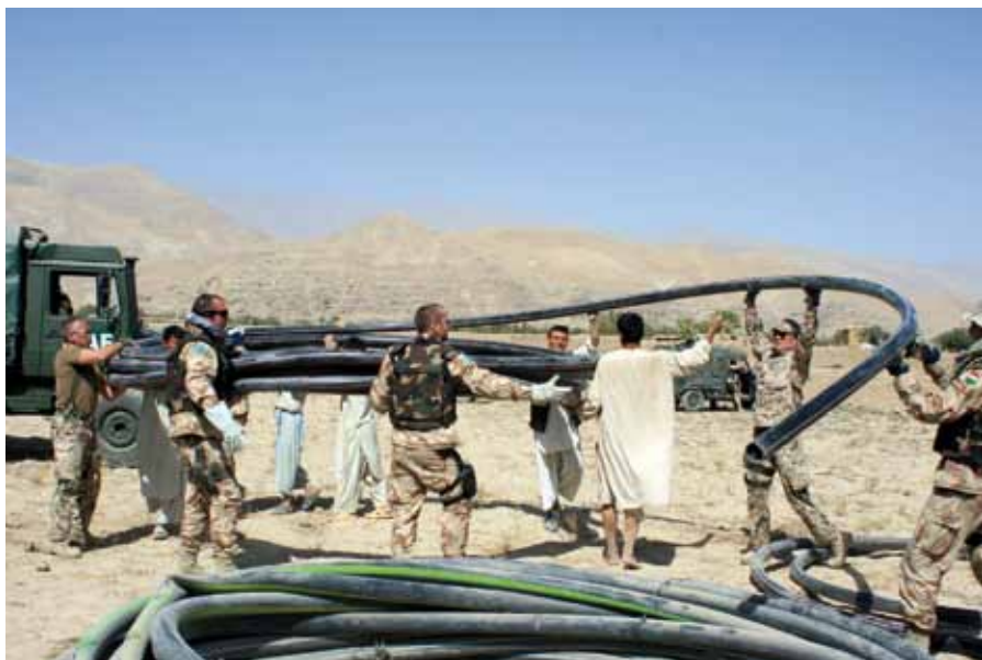
Canalisations d'eau de la FIAS à Baglan
