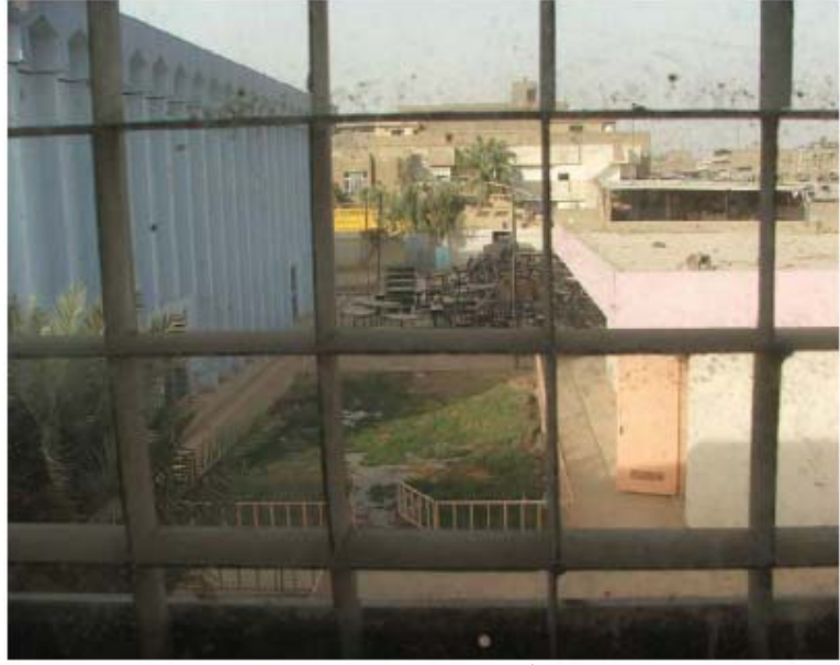
لا توجد ستائر على النوافذ والأنقاض في حديقة المدرسة ظاهرة في ساحة مدرسة القدس
