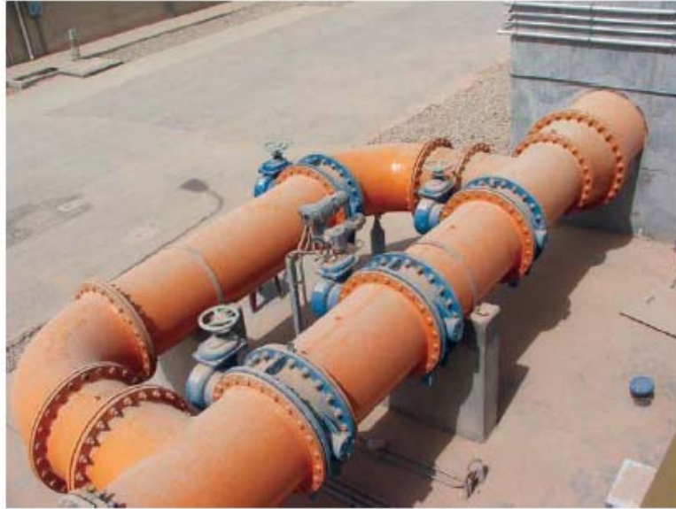
مشروع مياه مدينة الصدر: أجهزة قياس المياه غير المعالجة ومحطة مراقبة التدفق
