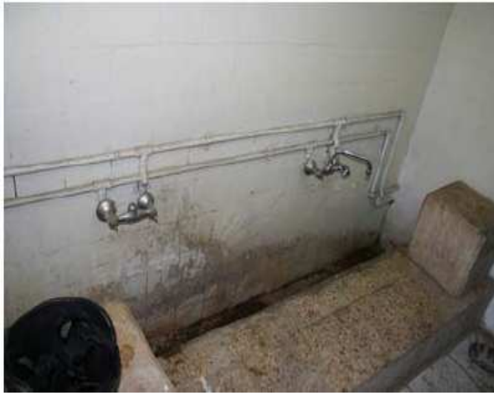
صورة الموقع 16 – تم دهان بلاط الجدار الموجود، ولم يتم استبدال الحنفيات المتسربة. الحنفية اليسرى في وسط الصورة غطيت/عطلت بدلا من استبدالها كما هو مطلوب.
