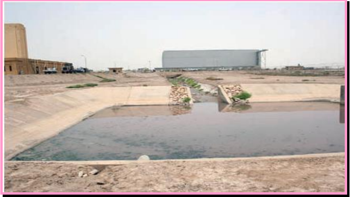
بركة تجميع مياه الأمطار وتبدو فيها مياه صرف صحي عادمة
