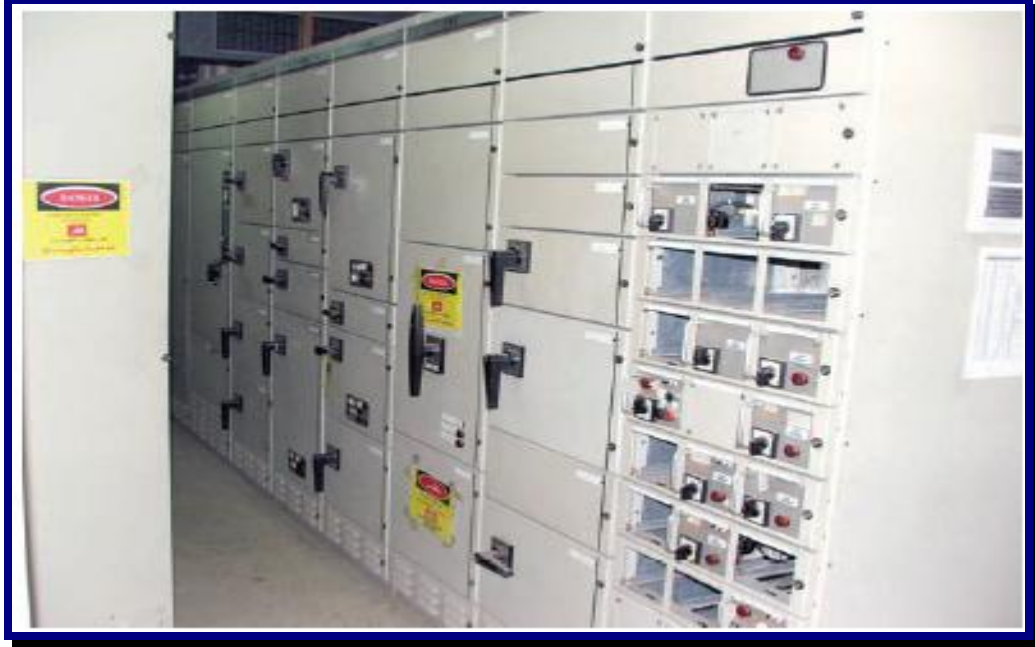
غرفة المراقبة الرئيسية. تم انتزاع القواطع لإبقاء المولدات الأخرى تعمل
