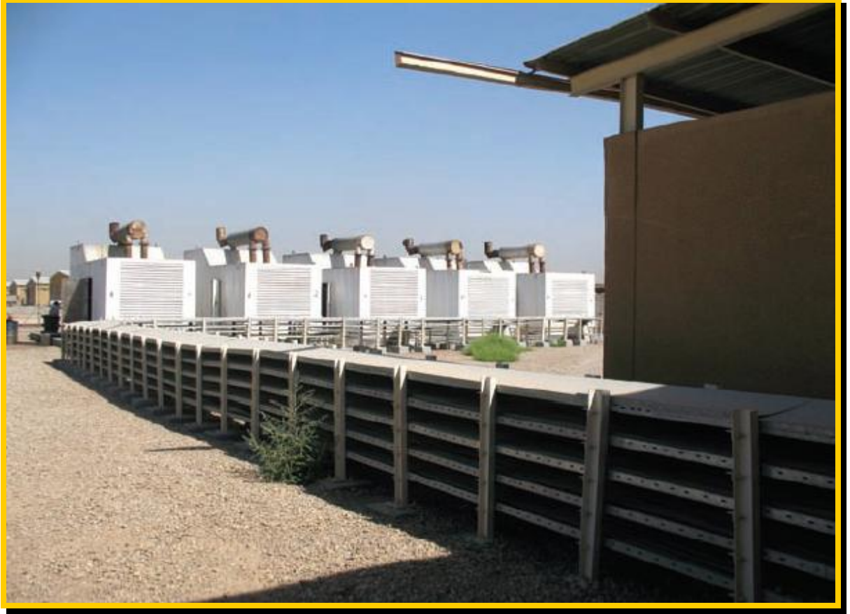
مولدات وأسلاك كهربائية تتجه نحو غرفة الكهرباء
