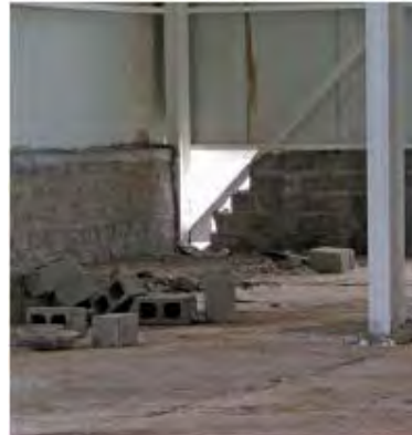
أعمال بناء غير صحيحة في مصنع الألبان في أبو غريب
