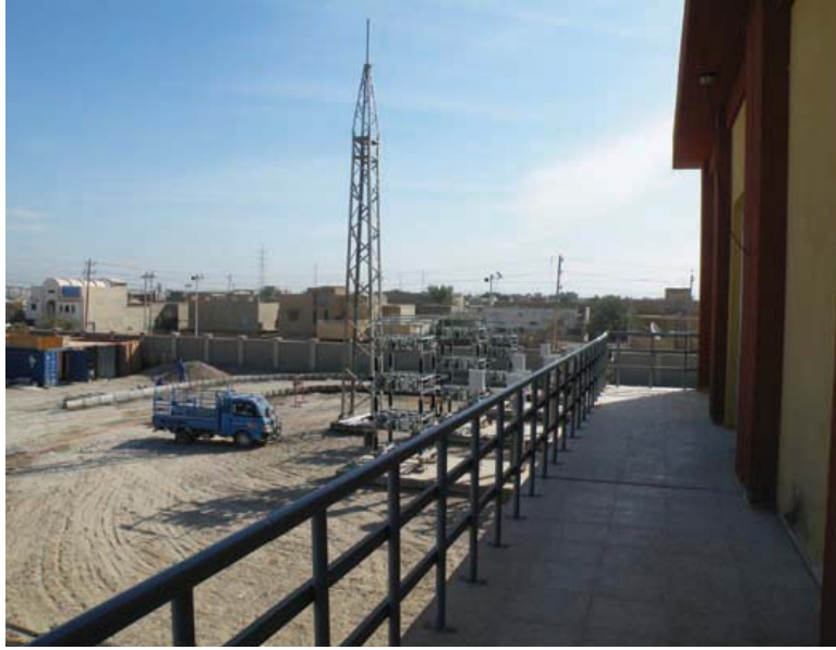
منظر من مبنى محطة التحويل
