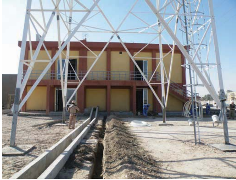
مسارات خنادق كابلات الكهرباء في مبنى محطة التحويل
