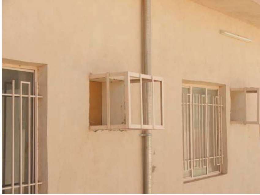
تركيبات وحدات تكييف الهواء بدون وحدات تكييف الهواء.
