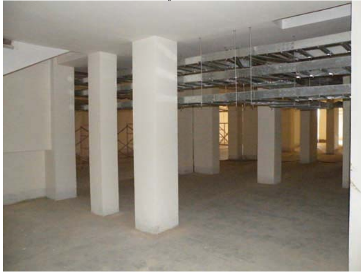
أعمدة الطابق الأرضي وحاملات كابلات الكهرباء الداخلية في محطة التحويل
