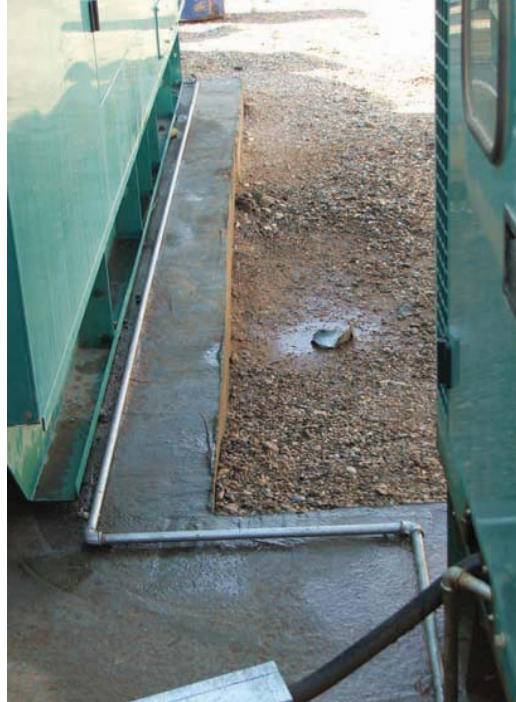
تسرب وقود الديزل وخط إمداد الطاقة الكهربائية غير المركب بصورة صحيحة
