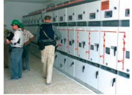
صورة الموقع ٢٦، محطة الحمدان الفرعية لتوزيع الكهرباء- اللوحات الكهربائية ١١ كيلو فولت أثناء التقييم الأولي.
