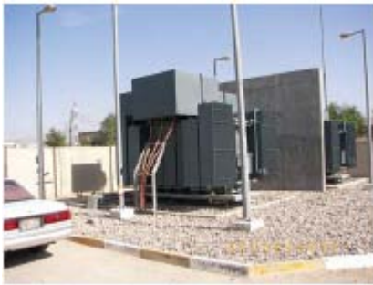
صورة الموقع ٢٩، محول الكهرباء ١١/٣٣ كيلو فولت في السراجيئي أثناء التقييم الثاني
