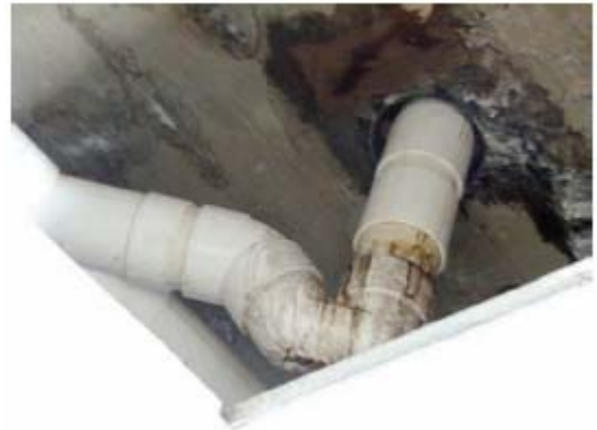
صورة الموقع رقم ١٩: تأثيرات تسرب المياه المصروفة على أنابيب المياه
