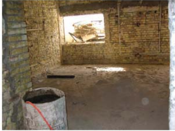
صورة الموقع رقم ٣: جناح المرضى في المبنى B9 بعد نزع التجصيص والأرضية
