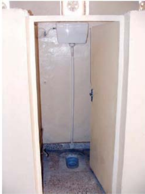
صورة الموقع رقم ١٢: مرحاض في حامية اللواء الثاني تظهر تركيبات أنابيب المياه البلاستيكية
