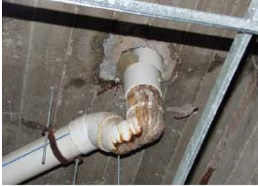
صورة الموقع رقم ٢٠: تأثيرات تسرب المياه المصروفة على أنابيب المياه
