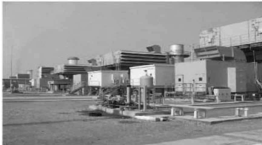
وحدات مولدات توربينات الغاز في محطة الطاقة الكهربائية في قدام
