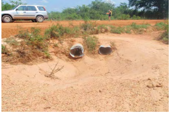
Crossing Structure: DS
