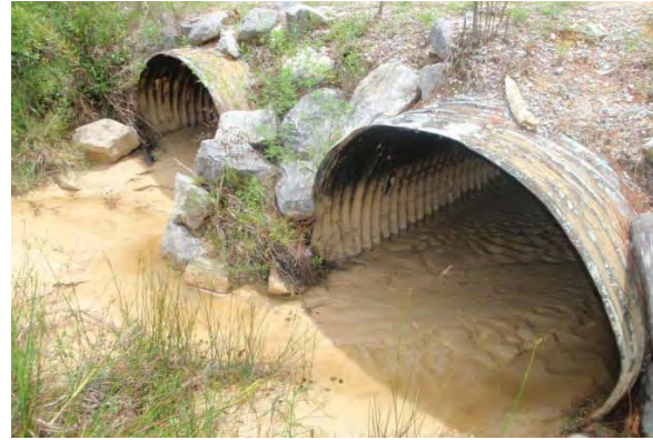
Crossing Structure: DS
