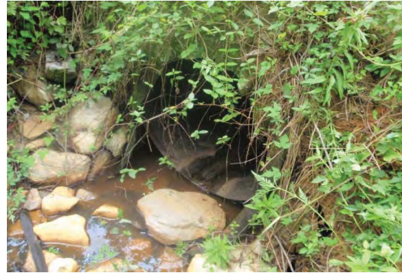
Crossing Structure: DS
