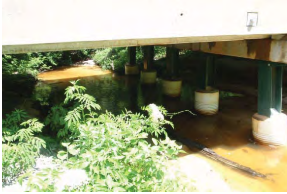
Crossing Structure: DS
