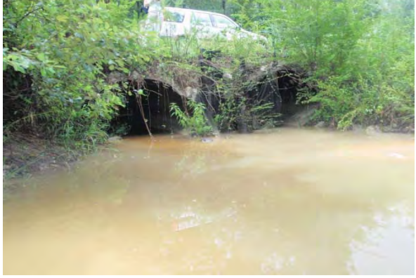
Crossing Structure: DS
