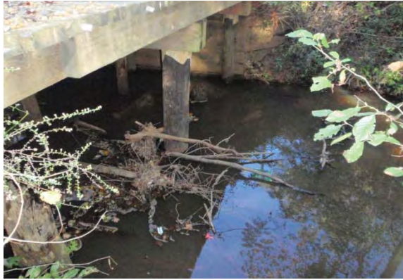
Crossing Structure: DS
