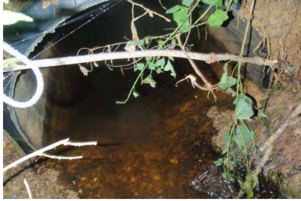
Crossing Structure: DS
