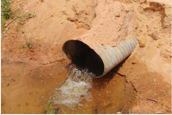
Crossing Structure: DS
