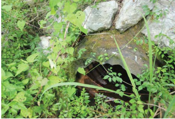
Crossing Structure: DS
