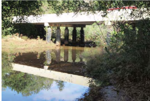
Crossing Structure: DS
