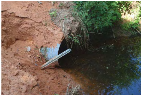
Crossing Structure: DS
