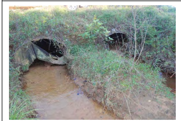
Crossing Structure: DS
