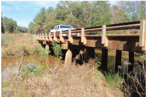
Crossing Structure: DS
