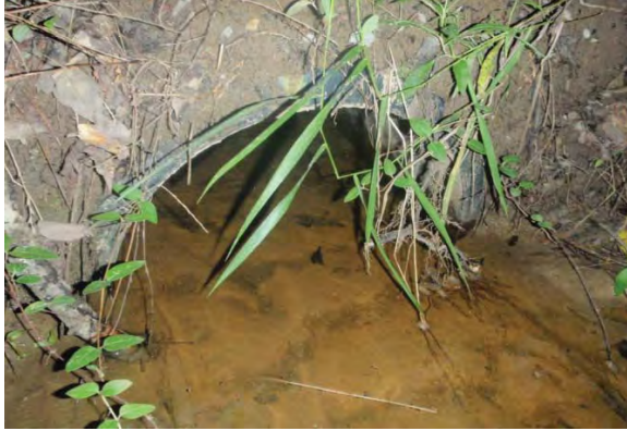
Crossing Structure: DS
