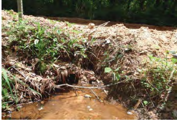
Crossing Structure: DS
