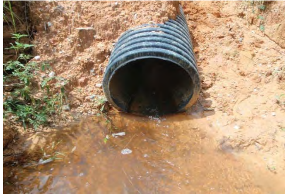
Crossing Structure: DS
