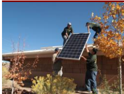
Santa Clara Pueblo Solar Array (Summer 2012)
