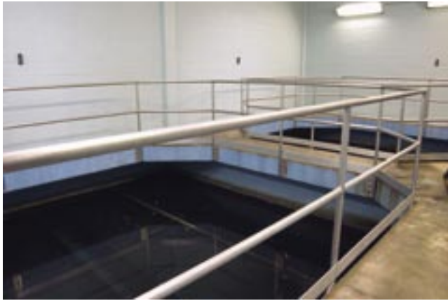
Tanque de filtración del sistema de agua
