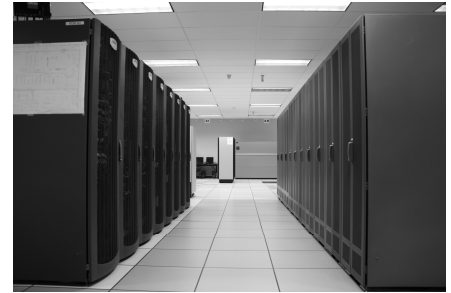
The Salt Lake Data Center
