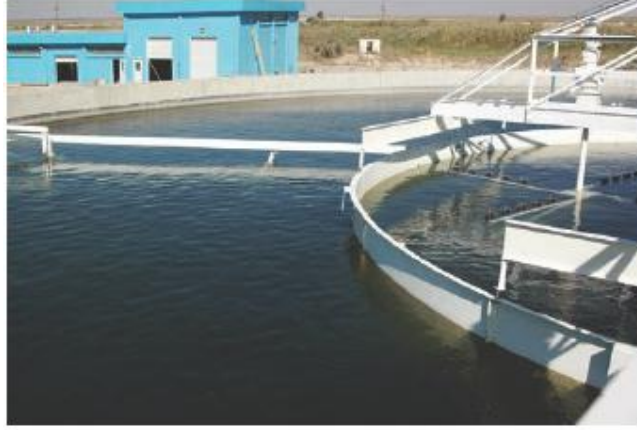
محطة لمعالجة المياه تمّ تجديدها
