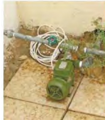
تمديدات أسلاك كهربائية لمضخة الإمداد في مدرسة الخندق المتوسطة
