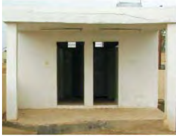
مبنى المراحيض الجديد يظهر صدعاً محزراً مهماً
