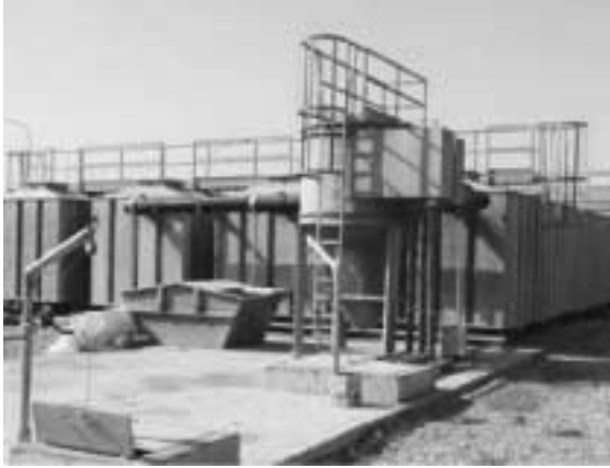
محطة معالجة المياه المصروفة
