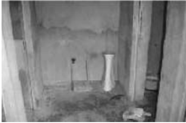
تجهيزات غرفة حمام في مخفر حدودي
