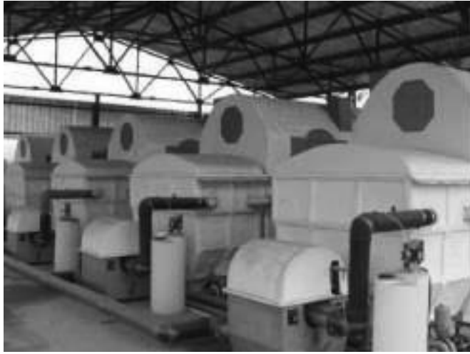
محطة معالجة المياه المصروفة المدمجة ضمن الأكاديمية العسكرية في زاخو
