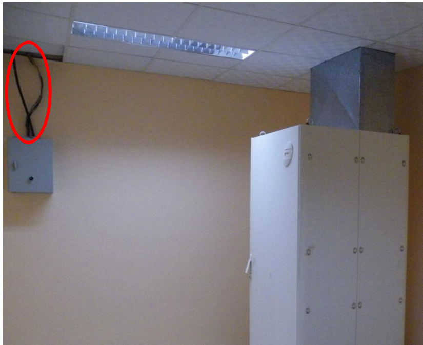
Site Photo 21. Electrical wiring not in conduit
