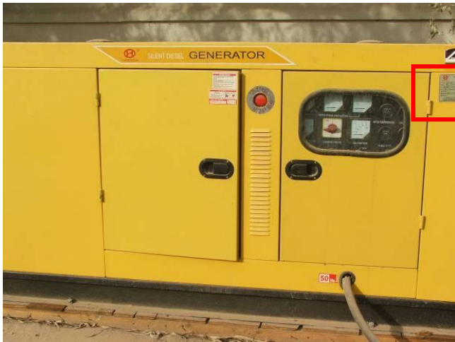
Site Photo 18. Generator (Al Quds)
