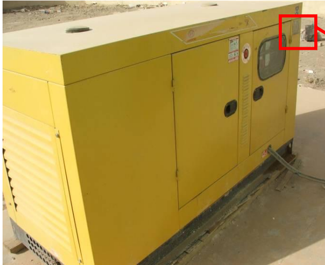
Site Photo 20. Generator (Al Faoo)
