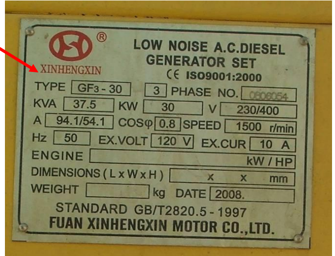
Site Photo 23. Generator ID (Al Faoo)
