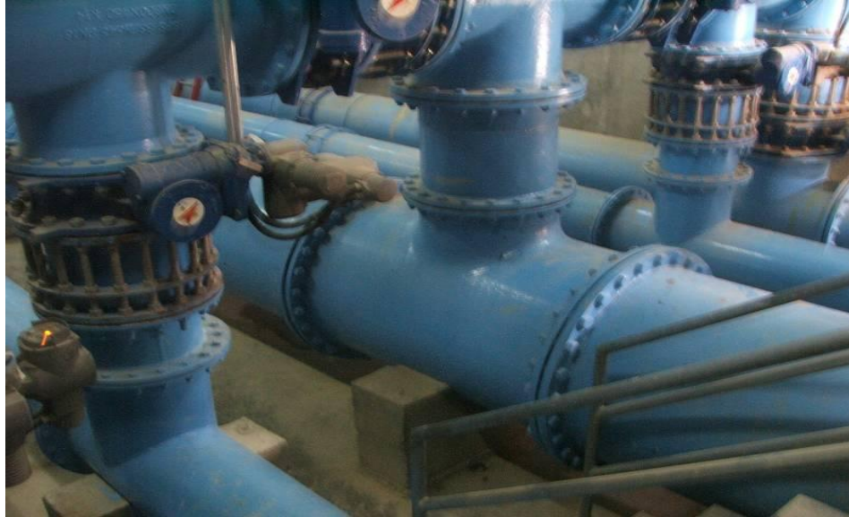
Site Photo 16. Filter effluent piping
