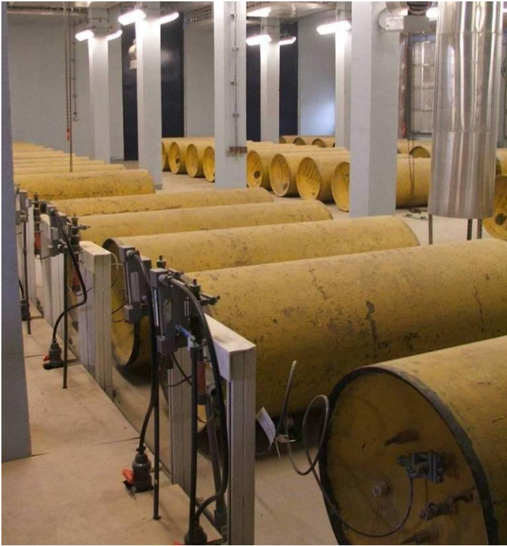
Site Photo 24. Chlorine cylinders
