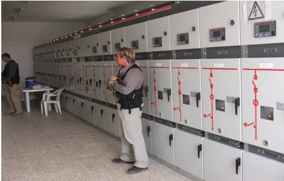
Site Photo 2: 11 kV switchgear
